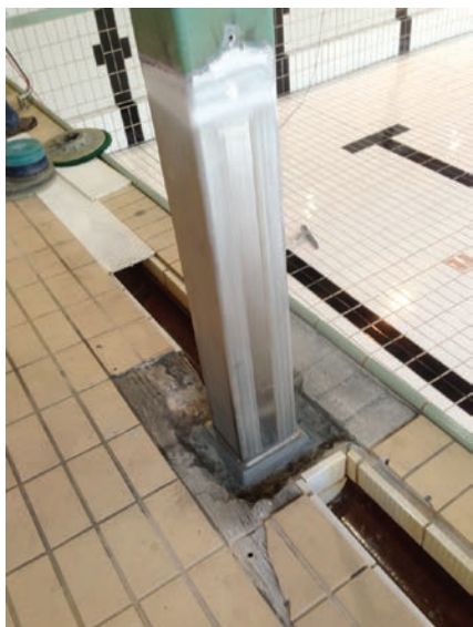
Raccord entre la colonne existante (en vert) et le segment remplacé en acier INOX 4404 (en gris)
